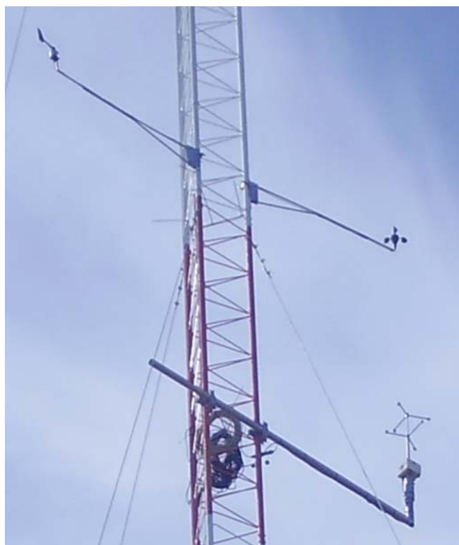
Figura 4 – Esquema de montagem dos sensores na estação PORT323 (30 m ans)
